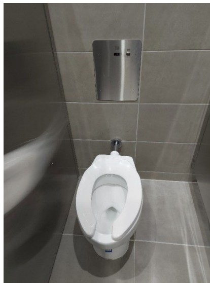
Imagen 25: Sistema inodoro con sensor instalado – Batería sanitaria.
